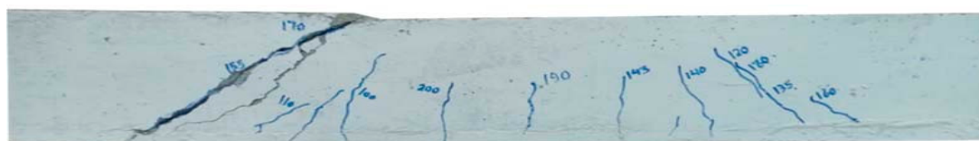
(d) Shear failure of a beam (B4)
